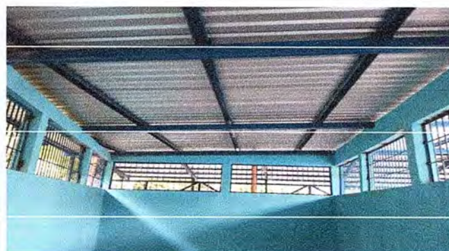
Foto 2: Se observa que se cambió de la estructura de soporte de madera por metal.
