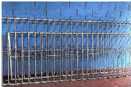
FOTO 9. SE OBSERVA QUE LOS BALCONES DE COCINA VAN A SER SUSTITUIDOS.
