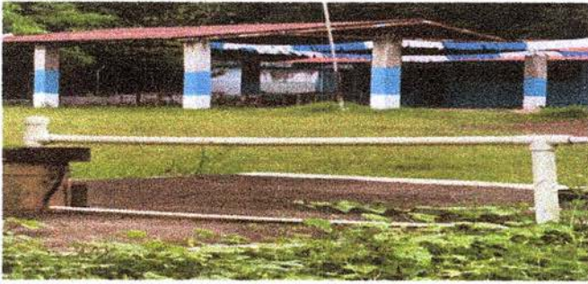
FOTO 13. SE OBSERVA QUE LA LINEA PRINCIPAL DE TUBERÍA DE PVC DE AGUA POTABLE ENTERRADA SE ENCUENTRA EN MAL ESTADO, POR LO QUE REQUIERE SUSTITUCIÓN.
