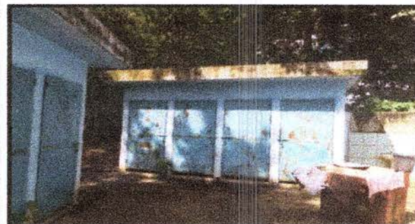
FOTO 10.. SE OBSERVA QUE LA PINTURA DE LAS PUERTAS DEL BAÑO REQUIEREN MANTENIMIENTO.
