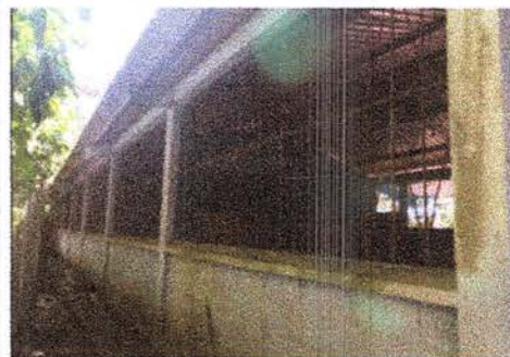
Foto 2: SE OBSERVA QUE LOS BALCONES DE METAL REQUIEREN MANTENIMIENTO CON PINTURA ANTICORROSIVA.
