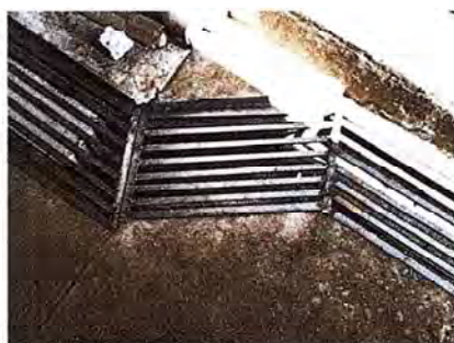
Foto 8: Se observa rejilla de metal nueva
