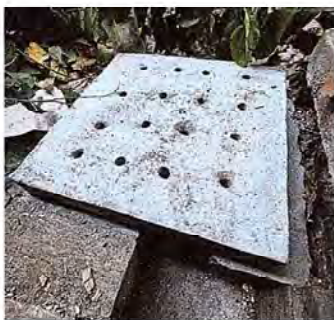
Foto 7: Se observa caja de registro nueva
