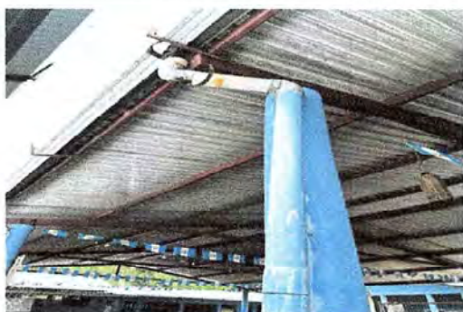
Foto 9: Se observa el deterioro de tubería PVC línea principal de aguas pluviales.
