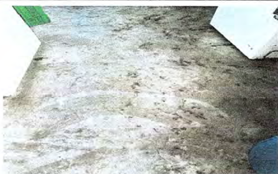
Foto 3: Se observa que la cocina no cuenta con azulejo.
