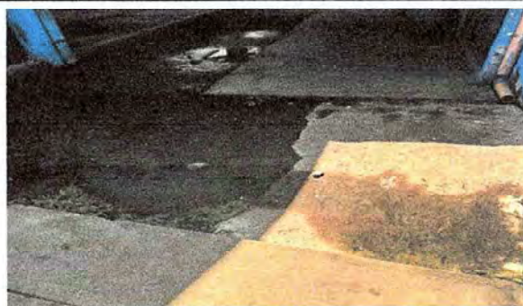
Foto 16: Se observa que la torta de concreto necesita reparación.
