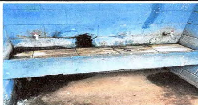
Foto 12: Se observa que urge reparación en lavamanos de concreto.
