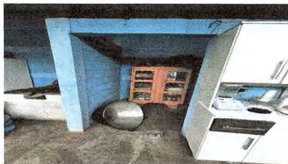
Foto 4: Se observa que no hay puerta en área de bodega de alimentos. Suministro de puerta de metal en cocina.
