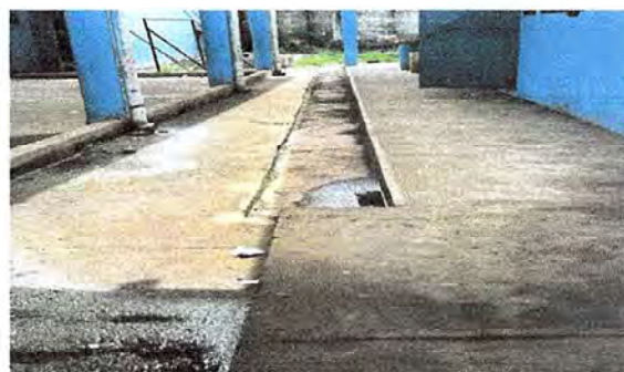
Foto 8: Se observa que en el patio no se cuenta con rejilla, el cual será suministrada.
