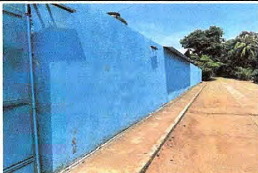
Foto 13: Se observa que urge un resane y aplicación de pintura en muros exteriores e interiores.
