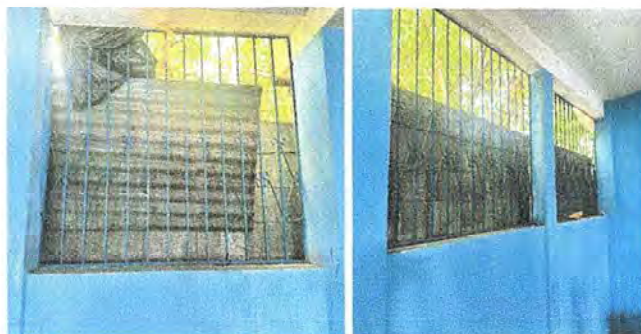
Foto 2: Se observa que se necesita ventana con vidrios.
