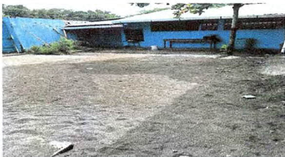
Foto 11: Se observa que no se cuenta con torta de concreto en el patio. El cual se suministrará.
