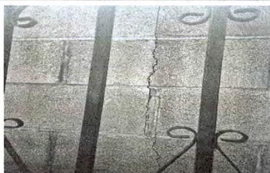
Foto 10: Se observa daño y urge reparación en muro perimetral de block.
