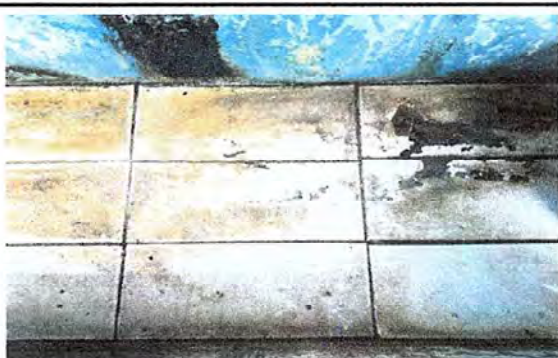
Foto 15: Se observa que se necesita sustitución de azulejo.
