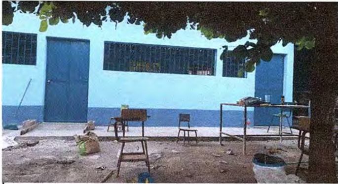
Foto 1: MODULO 3 SE OSERVA LAS PAREDES TOTALMENTE REMOSADAS.
