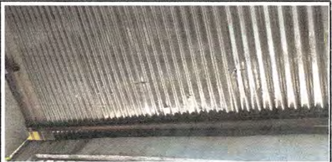
FOTO 4: SE OBSERVA QUE SE NECESITA CAMBIO DE LÁMINAS
