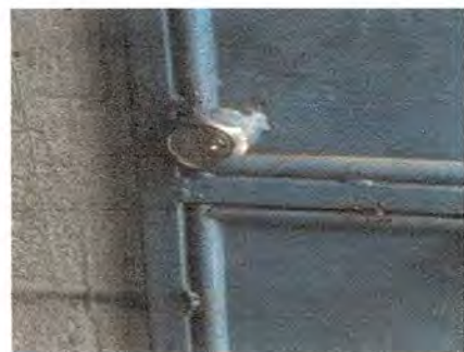
FOTO 6: SE OBSERVA QUE SE NECESITA CAMBIO DE CHAPA
