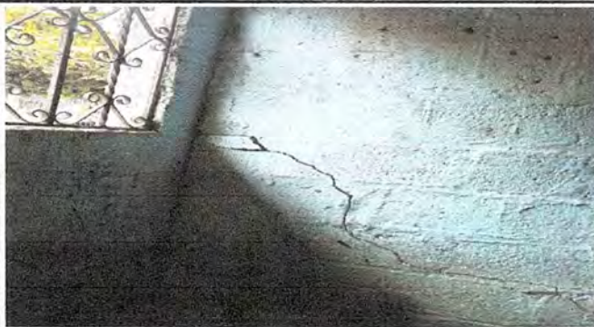
FOTO 3: SE OBSERVA GRIETAS Y FISURAS EN LAS PAREDES.
