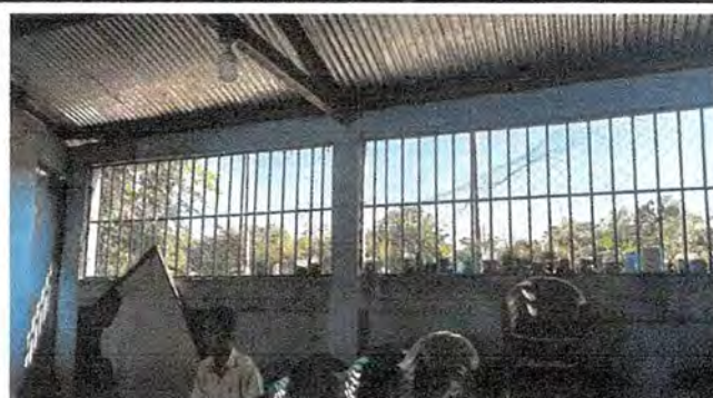
FOTO 8: SE OBSERVA QUE SE NECESITA VENTANAS CON URGENCIA.
