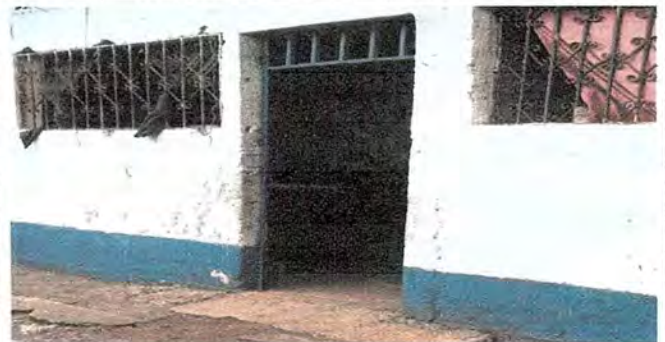
FOTO 2: MODULO 3, SE OBSERVA PUERTA EN MAL ESTADO.
