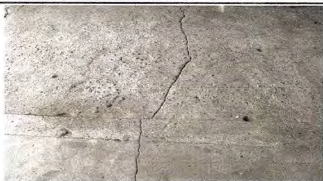
FOTO 7: SE OBSERVA EL PISO EN MAL ESTADO DEL MODULO 4.
