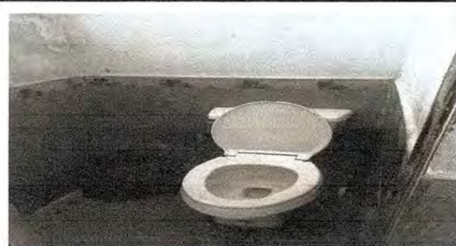
FOTO 10: SE OBSERVA QUE SE NECESITA MANTENIMIENTO EN LOS SERVICIOS SANITARIOS.
