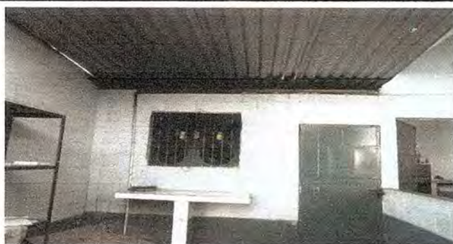
FOTO 9: SE OBSERVA QUE NO CUENTA CON SISTEMA ELÉCTRICO.
