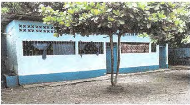
FOTO 1: MODULO 3, SE OBSERVA QUE LAS PAREDES SE ENCUENTRA EN MAL ESTADO.
