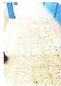
Foto 2: Se observa que el piso de granito ya se encuentra desgastado
