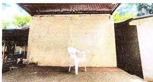
Foto 7: Se observa que la pared del fondo del escenario necesita aplicación de repello y cernido.
