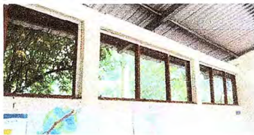
Foto 1: Se observa que las ventanas son de cedazo y se requiere que sean de balcón de metal para mayor seguridad.
