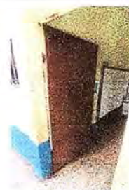
Foto 4: Se observa que las puertas del módulo 2 requieren mantenimiento pues ya empiezan a presentar corrosión.
