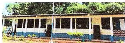
Foto 3: Se observa que la lámina del módulo 2 necesita aplicación de pintura anticorrosiva para poder preservarse por más tiempo.
