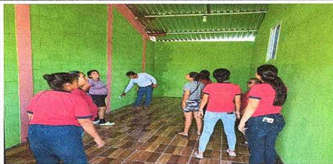
Foto 6: SE OBSERVA QUE LOS MUROS INTERNOS NECESITAN RESANE Y APLICACIÓN DE PINTURA LÁTEX ACRÍLICA
