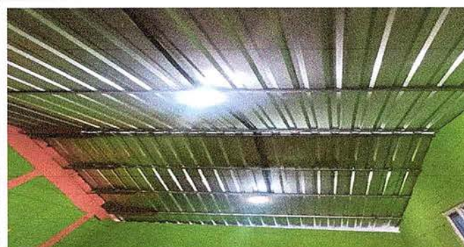
Foto 4: SE OBSERVA QUE LA CUBIERTA DEL MÓDULO DE AULAS 1 YA FUE SUSTITUIDA.
