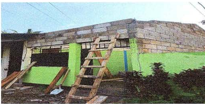
Foto 3: SE OBSERVA QUE SE LEVANTA DEL MÓDULO 1 MOJINETE.
