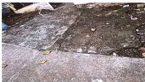
Foto 9: Se observa que la plancha de concreto se encuentra en mal estado.
