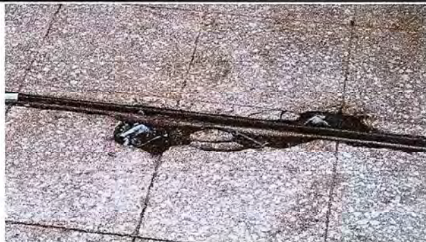
Foto 7: Se observa que el piso se encuentra en mal estado.
