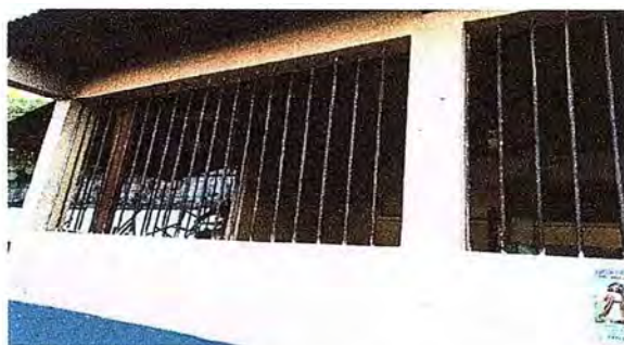
Foto 3: Se observa que los balcones se encuentran en mal estado.
