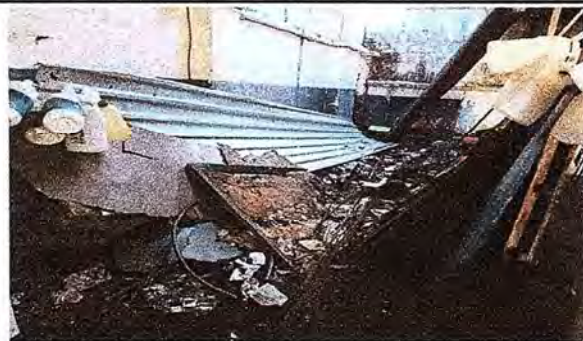
Foto 8: Se observa que no se cuenta con torta de concreto.
