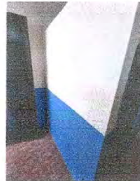
Foto 8: Se observa paredes pintadas
