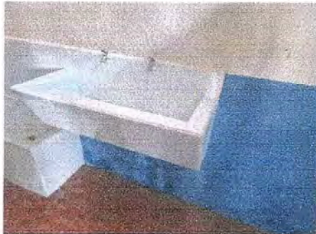
Foto 7: Se observa chorros cambiados
