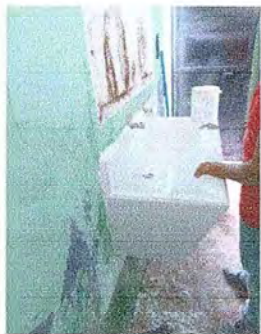
Foto 7: Se observa chorros desmontados para cambio
