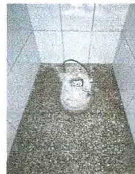
Foto 4: Se observan inodoros desmontados para cambio
