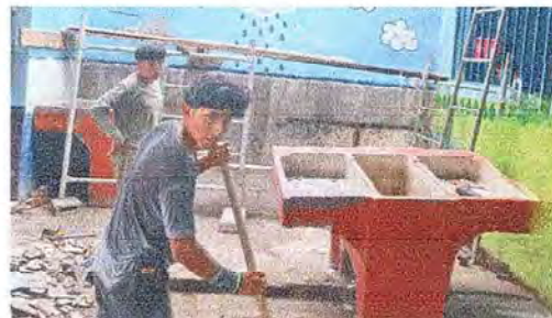
Foto 14: Se observa pila en mal estado retirada
