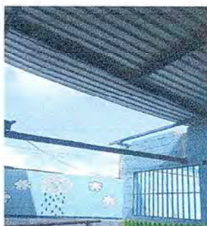
Foto 11: Se observa lámina vieja retirada
