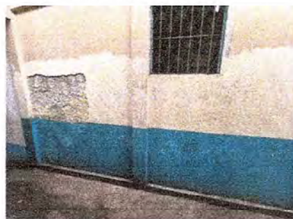
Foto 16: Se observa pared dañada en el repello.
