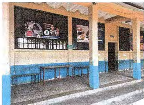
Foto 19: Se observa pared sucia
