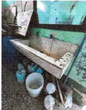
Foto 7: Se observan chorros en mal estado
