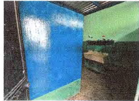
Foto 8: Se observan paredes con pintura dañada
