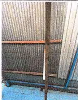
Foto 11: Se observa lámina vieja acanalada en uso y con partes oxidadas
