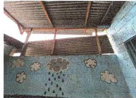
Foto 10: Se observa que muro del área de pila necesita mejoras
