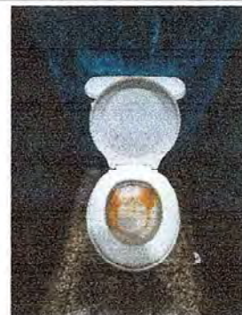
Foto 4: Se observan inodoros, manchados, con falta de accesorios y problemas de funcionamiento
