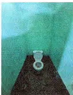
Foto 5: Se observan paredes sin azulejo, rayadas y desgastadas
