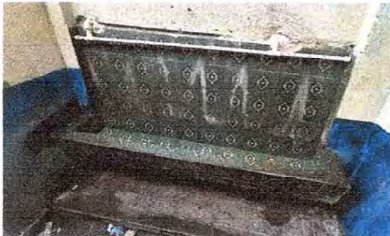
Foto 9: Se observa mingitorio de concreto y azulejo en mal estado
