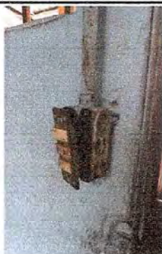
Foto 15: Se observa sistema eléctrico con deficiencias, tomacorrientes sin energía, falta de funcionamiento de los apagadores y faltante de luminarias.
