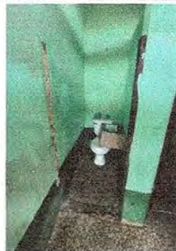
Foto 2: Se observa carencia de puerta de baño
