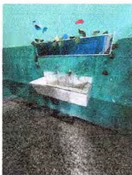
Foto 1: Se observa piso con pedazos faltantes y en mal estado.
