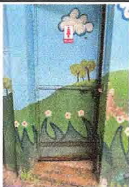
Foto 3: Se observa puertas de ingreso en mal estado y grado avanzado de corrosión
