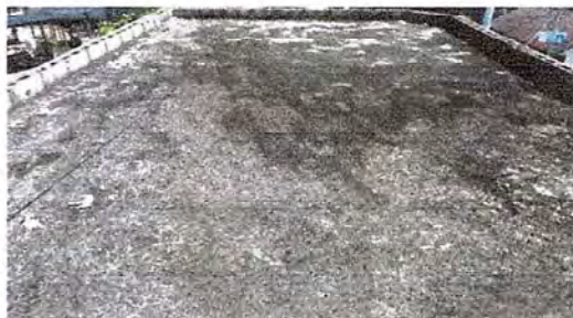
Foto 18: se observa problemas con filtración en losa de concreto de dirección
