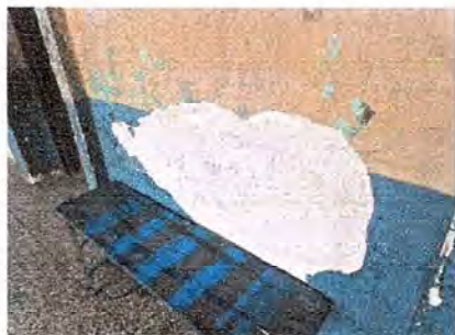
Foto 17: Se observa pared con cernido dañado
