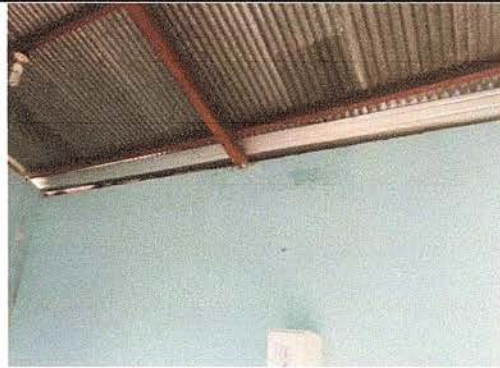
Foto 8: Se observa la finalización en el agua de lluvia que se filtra por el mojinete, está afectando los muros.
