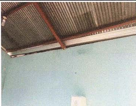
Foto 7: Se observa la finalización en el canal ubicado en el módulo de aulas 2, ya no funciona correctamente
