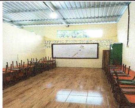
Foto 2: Se observa la finalización en el módulo de aulas 1 tiene la lámina y estructura de metal en mal estado, urge su sustitución. Además es necesario sustituir el sistema eléctrico, el cual se dañará al desmontar la
