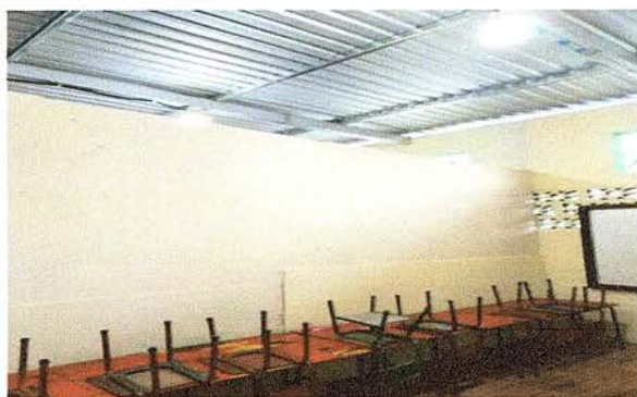
Foto 3: Se observa la finalización en la altura de los muros del módulo de aulas 1 no es la adecuada y no cuenta con ventilación cruzada
