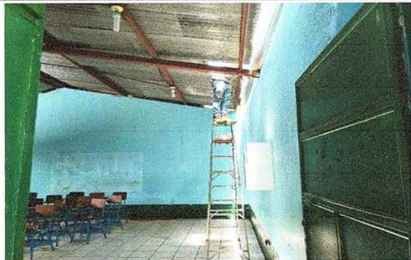
Foto 7: Se observa el proceso que el canal ubicado en el módulo de aulas 2, ya no funciona correctamente
