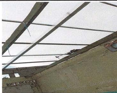
Foto 2: Se observa el proceso que módulo de aulas 1 tiene la lámina y estructura de metal en mal estado, urge su sustitución. Además es necesario sustituir el sistema eléctrico, el cual se dañará al desmontar la
