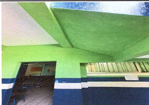
Foto 9: Se observa el proceso de humedad y desprendimiento de repello en el módulo de gradas
