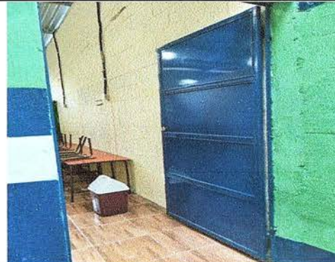
Foto 4: Se observa el proceso que la puerta del módulo de aulas 1, está en mal estado y el piso necesita mejora
