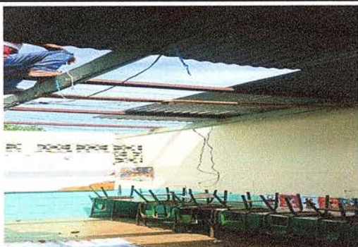
Foto 3: Se observa el proceso que la altura de los muros del módulo de aulas 1 no es la adecuada y no cuenta con ventilación cruzada
