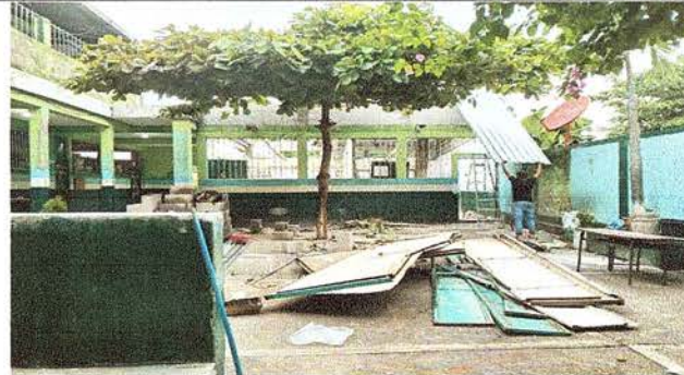
Foto 6: Se observa el proceso que los muros necesitan mantenimiento
