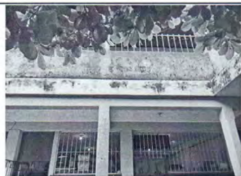
Foto 6: Se observan que los muros necesitan mantenimiento
