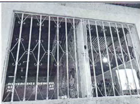
Foto 5: Se observa que balcones necesitan mantenimiento preventivo
