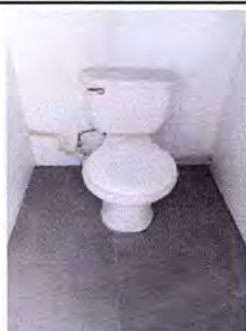
Foto 3: Se observan que el azulejo de los baños y el inodoro bué sustituido.
