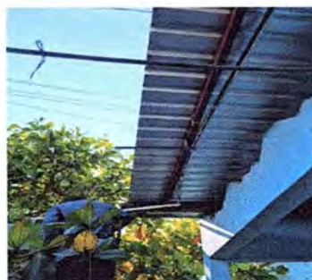
Foto 12: Se observan la instalaciones del canal por cada módulo.
