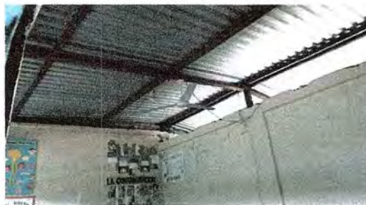
Foto 10: Se observa que el sistema eléctrico se encuentra en mal estado.
