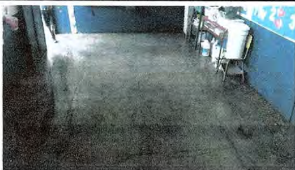
Foto 15: Se observa piso en mal estado.
