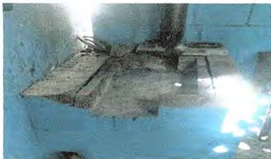
Foto 7: Se observa estufa en mal estado.
