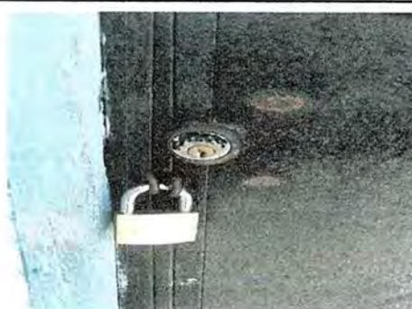
Foto 14: Se observa chapas en mal estado.
