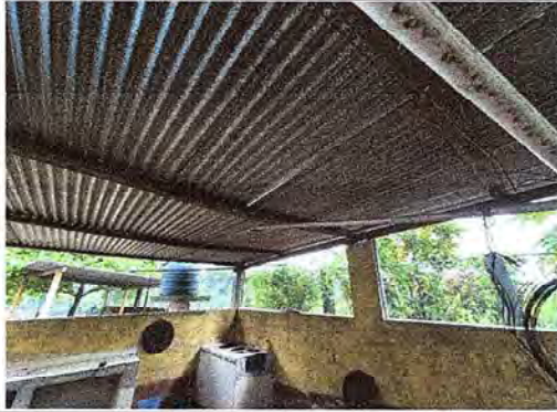
Foto 1: Se observa la lámina deteriorada urge cambio
