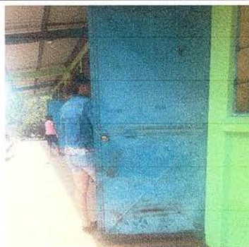
Foto 4: Las puertas del módulo de aulas están deterioradas, necesitan mantenimiento.
