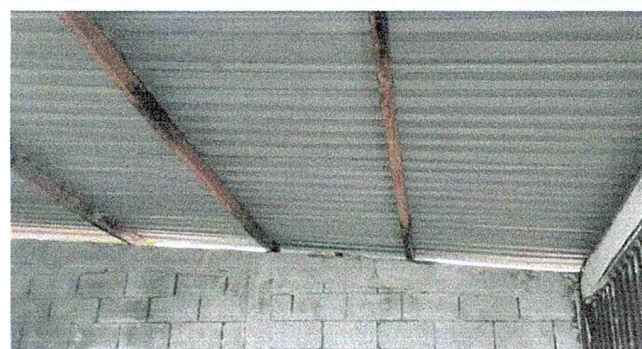
Foto 2: Se observa el soporte de madera esta dañado.
