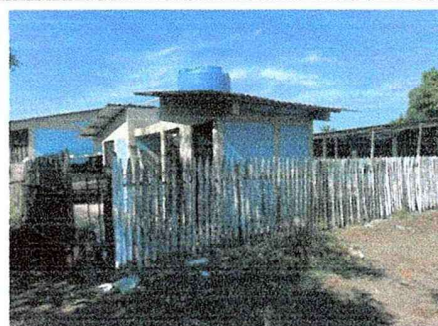
Foto 4: Se evidencia que el perímetro esta en mal estado
