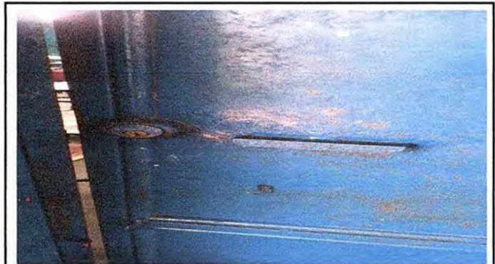
FOTO 4: SE OBSERVA LAS PUERTAS EN MAL ESTADO
