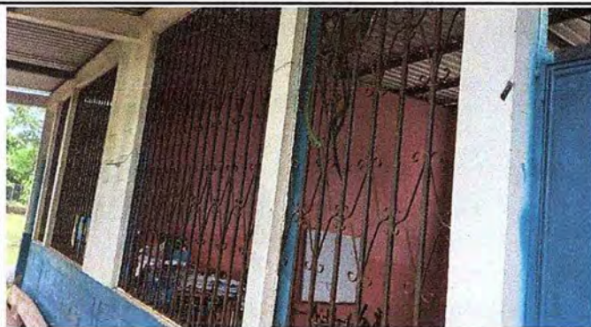
FOTO 3: SE OBSERVA BALCONES EN MAL ESTADO
