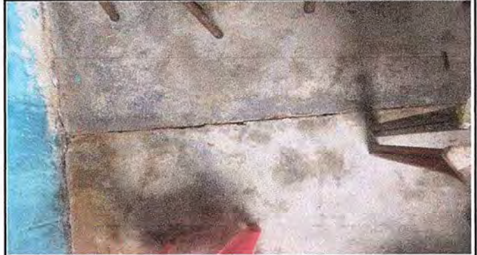
FOTO 2: SE OBSERVA QUE EL PISO DE CEMENTO DE MAL ESTADO
