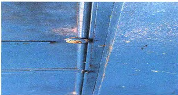
FOTO 5: SE OBSERVA CHAPA EN MAL ESTADO
