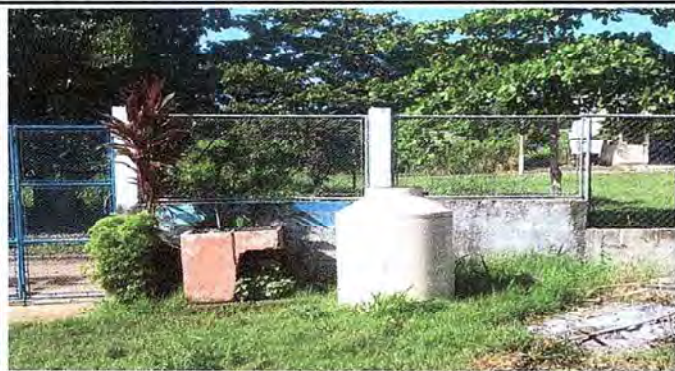
Foto 7: SE OBSERVA QUE EL ROTOPLAS NO CUENTA CON SU TORRE PARA CONTAR CON UNA MEJOR PRESIÓN DE AGUA.
