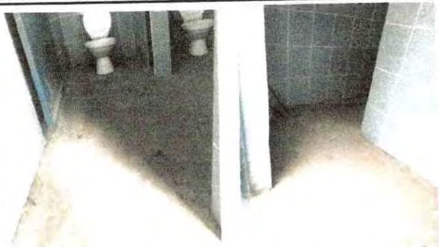
Foto 7: Se observa la necesidad de mejora en el piso de los baños implementando piso ceramico
