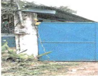
Foto 1: Se observa la necesidad de reparar columnas para mayor resguardo del perimero escolar
