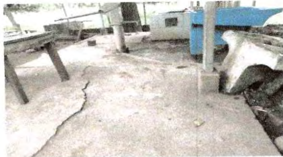
Foto 10: Se observa la necesidad de la reparacion de la torta de cemento
