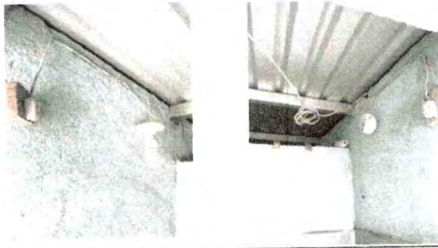
Foto 8: Se observa la necesidad del cambio del sistema electrico (focos, apagadores, plafoneras y tomacorrientes)
