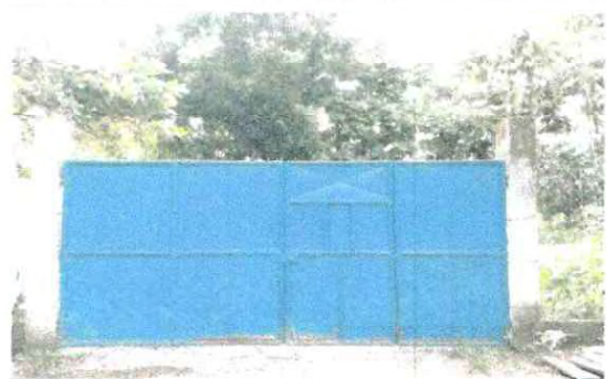
Foto 4: Se observa la necesidad de la instalacion de lamina para cubrir el area del porton
