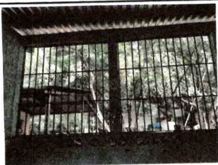
Foto 15: Se observa la necesidad de realizar las ventanas, en tiempo de lluvia entra agua y también se escucha el ruido exterior.
