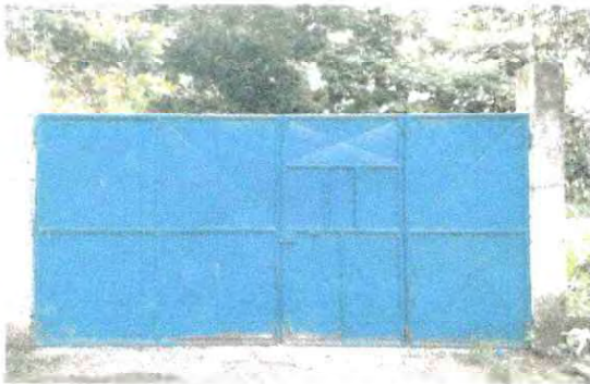
Foto 3: Se observa la necesidad de suministrar estructura de soporte de metal para cubrir el porton evitar la corrosion
