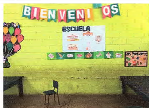
Foto 5: Se observa que las paredes se encuentran sucias
