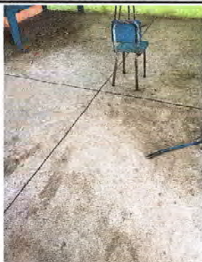
Foto 1: Se observa la falta de piso cerámico
