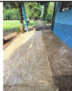
Foto 6: Se observa la falta de piso cerámico
