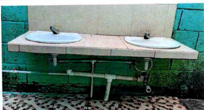
Foto 15: Se observa que los lavamanos los desagües están inservibles, se requiere reparación de las llaves de chorro.
