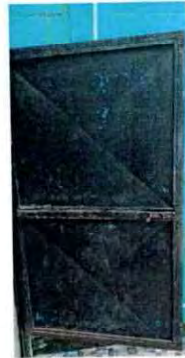
Foto 14: Las puertas de los baños requiere mantenimiento, deben de pintarse.
