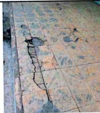
Foto 8: El piso de las aulas y los pasillos ya esta bastante deteriorado, se requiere cambiarlo completamente.
