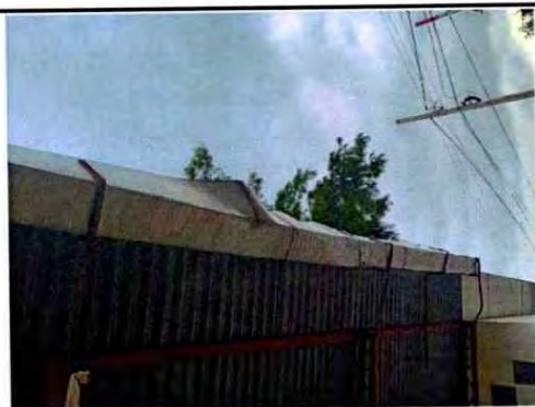
Foto 9: El canal del pasillo, requiere sustitución, se puede observar que esta dañado y al momento de las lluvias el agua se sale.
