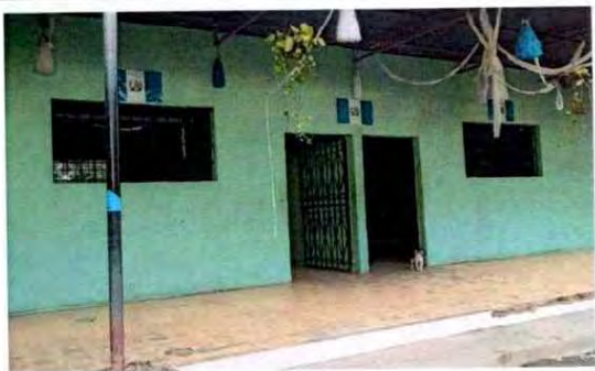
Foto 11: Se puede observar que las aulas solamente cuentan con reja, por seguridad es necesario suministrarles puertas de metal.
