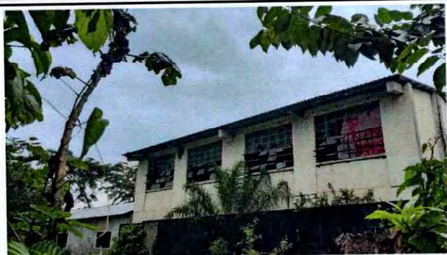
Foto 13: El metal de las ventanas es antiguo y esta en mal estado, por lo mismo se requiere colocar balcones por seguridad del centro educativo.
