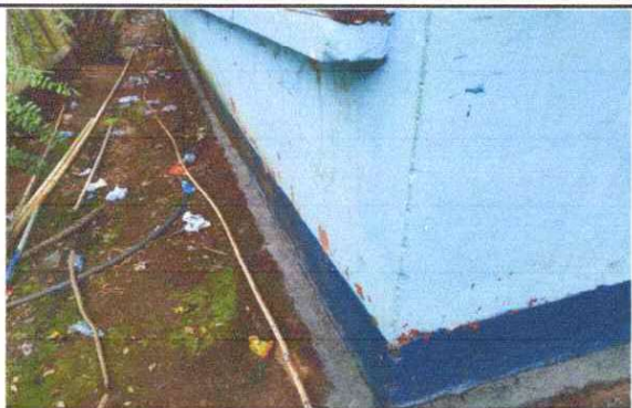
Foto 7: En esta fotografía se observa que la línea principal de agua ha quedado oculta con concreto, para proteger la tubería de daños provocados por los estudiantes
