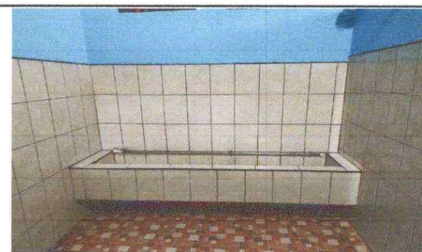
Foto 6: En esta fotografía se observa la finalización del remozamiento del mingitorio en el módulo de servicios sanitarios de hombres
