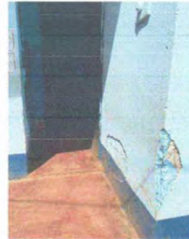
Foto 2: Se observa deterioro de pintura en las paredes interiores y exteriores de los módulos de los servicios sanitarios
