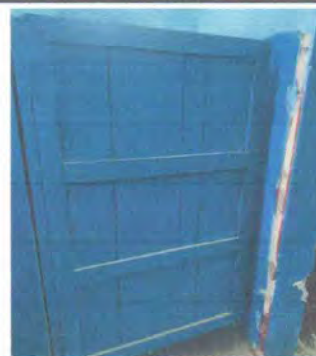
Foto 8: Las puertas que dividen cada uno de los baños, debido a que son de madera, se encuentran en mal estado
