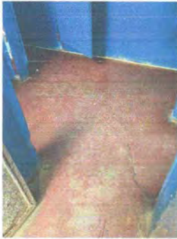
Foto 1: Se observa deterioro y grietas en el piso de los módulos de los servicios sanitarios
