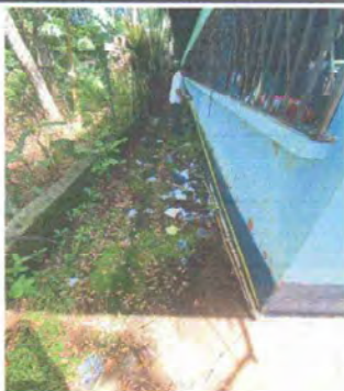
Foto 7: La tubería presenta fugas de agua, el deterioro es inminente por los años
