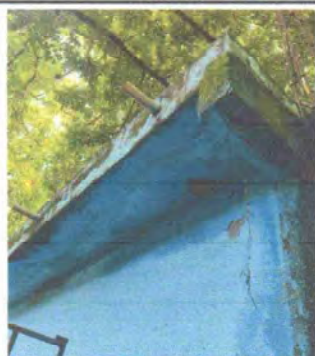
Foto 9: La losa cuenta con filtraciones de agua por tal motivo debe de se impermeabilizada
