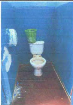
Foto 3: Se observan los sanitarios en mal estado, por tal motivo necesitan sustitución.
