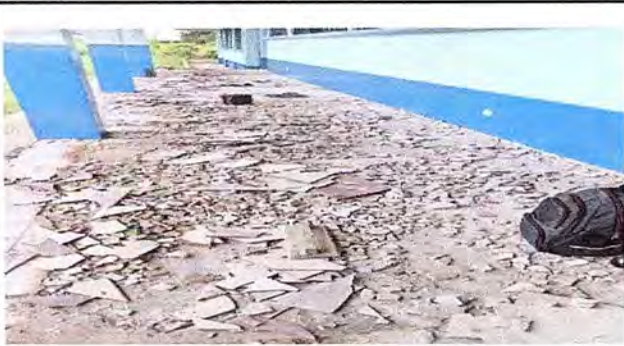
Foto 14: SE OBSERVA QUE EL PISO CERÁMICO LO ESTAN LEVANTANDO PARA PODER SUSTITUIRLO.
