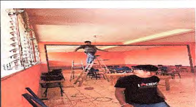
Foto 8: SE OBSERVA QUE ESTAN CAMBIANDO LOS ELEMENTOS DEL SISTEMA ELECTRICO
