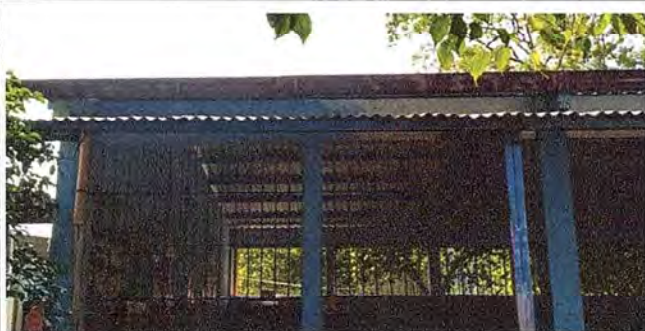
Foto 15: Se observa canal en mal estado
