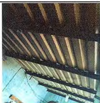
Foto 5: Se observa que cocina no cuenta con iluminación ni tomacorrientes
