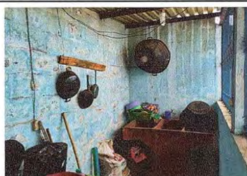
Foto 4: Se observa pared sucia
