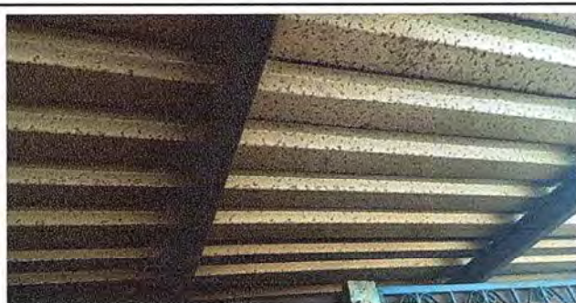
Foto 6: Se observa estructura de metal en mal estado
