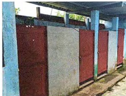
Foto 10: Se observan puertas con desgaste y falta de mantenimiento
