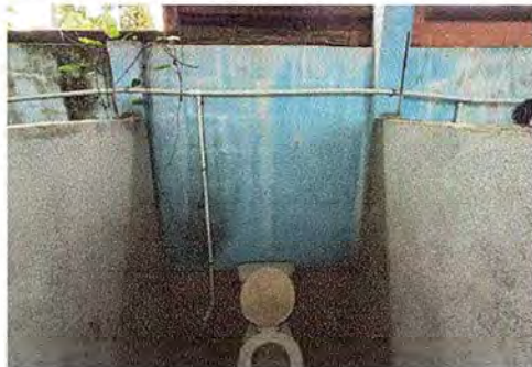
Foto 13: Se observa paredes sin azulejo en área de baños
