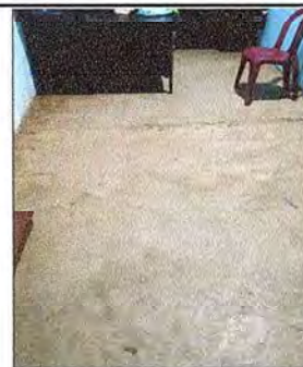
Foto 18: Se observa falta de piso cerámico
