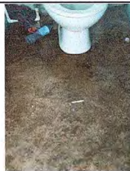
Foto 12: Se observa piso de baños sin antideslizante
