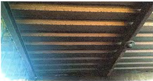
Foto 7: Se observa lámina deteriorada y mal estado
