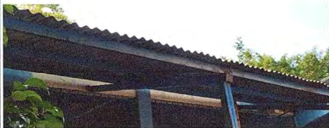
Foto 17: Se observa lámina en mal estado
