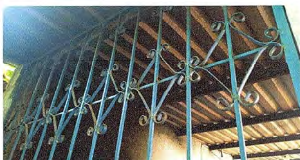
Foto 8: Se observan balcones con falta de mantenimiento
