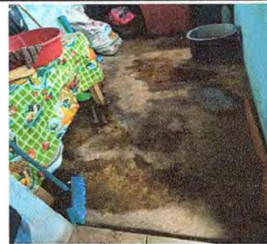
Foto 2: Se observa el piso de cocina en mal estado y sin piso cerámico
