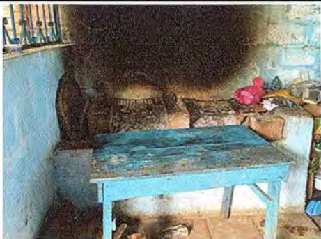
Foto 1: Se observa la estufa se encuentra en mal estado
