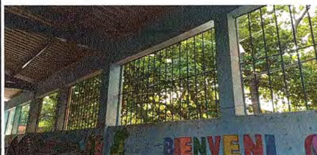
Foto 16: Se observa falta de ventanería
