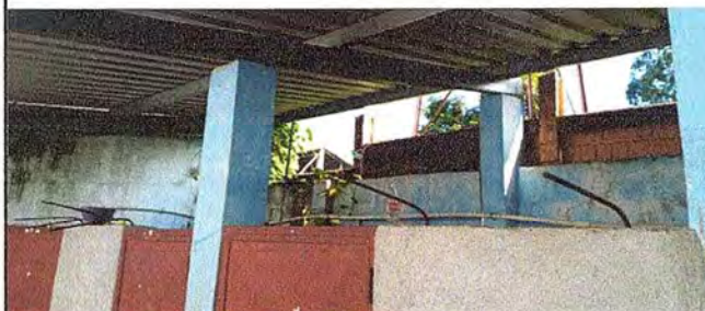
Foto 14: Se observa muro en mal estado
