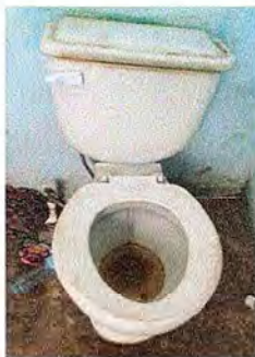
Foto 11: Se observan inodoros en mal estado con rajaduras y fugas de agua
