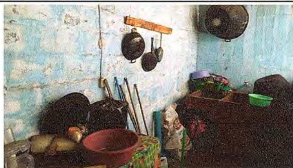
Foto 3: Se observa la pared sin azulejo
