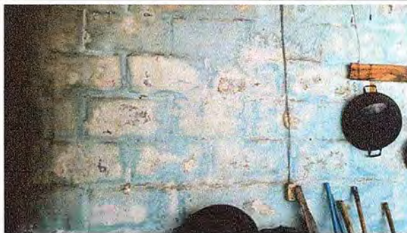
Foto 9: Se observa pared sin repello
