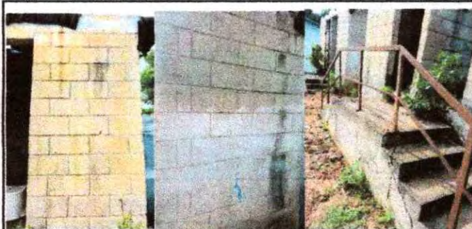
Foto 9. Se observa la necesidad de aplicación de pintura en las paredes exteriores de los baños para una mejora en los mismos
