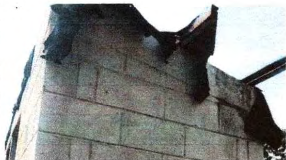
Foto 1. Se observa el techo en mal estado es necesario sustituir la Estructura metálica y la lámina
