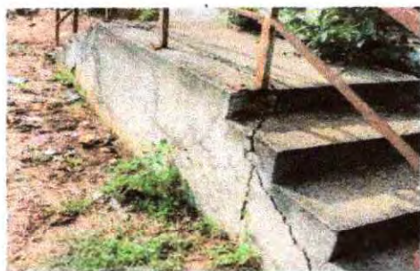
Foto 11. Se observa la necesidad de reparación de las gradas para evitar que arruinen por completo
