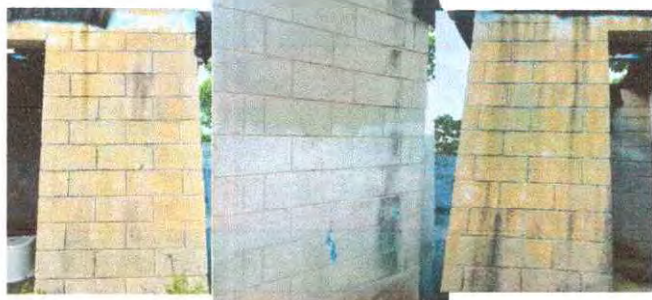
Foto 7. Se observa paredes en mal estado por lo que se necesita repellar las paredes
