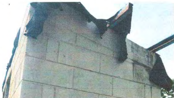
Foto 1. Se observa el techo en mal estado es necesario sustituir la Estructura metálica y la lámina
