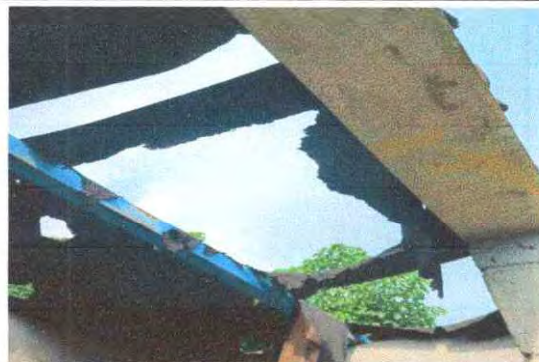
Foto 2. Se observa las láminas en mal estado por lo que es necesario sustituir las
