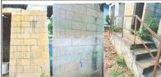
Foto 9. Se observa la necesidad de aplicación de pintura en las paredes exteriores de los baños para una mejora en los mismos
