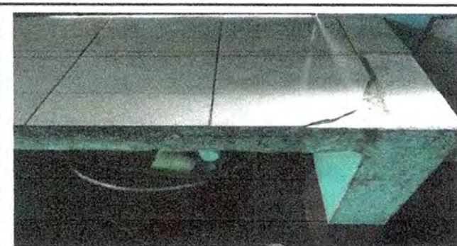
Foto 12: Se observa que se necesita reparación de azulejos en mueble de cocina
