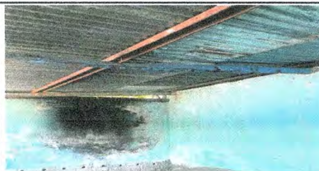
Foto 2: Se observa que se necesita sustitución de soporte de metal por metal.
