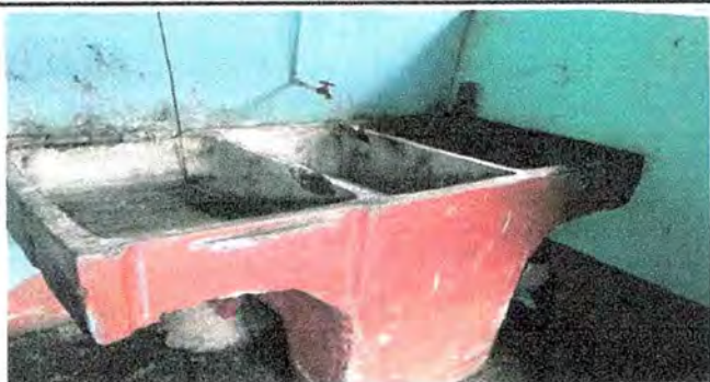
Foto 13: Se observa que la pila necesita sustitución.
