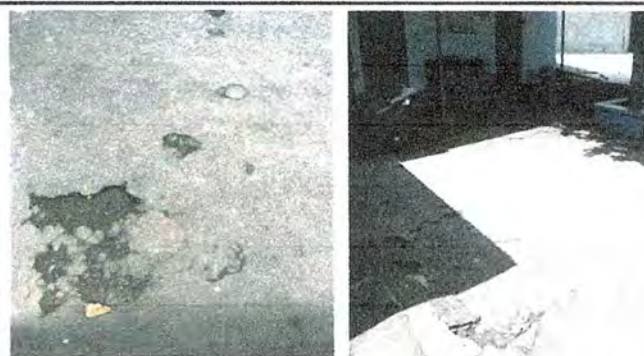
Foto 10: Se observan que se necesita reparación en plancha de concreto en patio.
