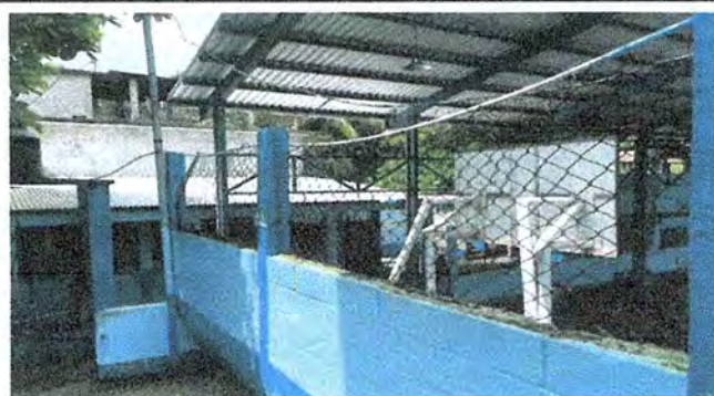
Foto 8: Se observa que se necesita realizar la sustitución de malla por baranda de metal.
