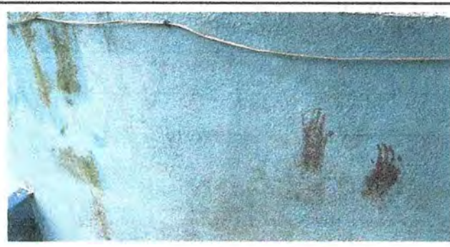
Foto 6: Se observa que se necesita aplicación de pintura latex acrilica en muros exteriores e interiores.
