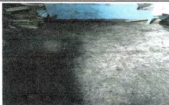
Foto 5: Se observa que se necesita realizar sustitución de torta de concreto por piso cerámico.
