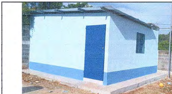
Foto 9: Se observa que se instaló y pintó una puerta en el acceso a cocina.
