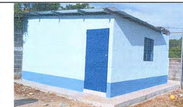
Foto 10: Se observa pintada la cocina tanto adentro como afuera
