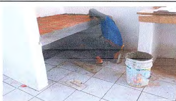
Foto 4: Se observa que la estufa esta siendo modificada
