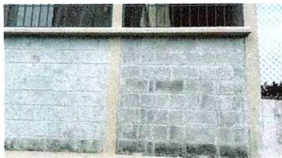
Foto 14: Se observa paredes de aulas tienen moho y pintura deteriorada
