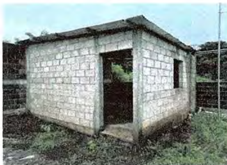
Foto 10: Se observa que ninguna pared cuenta con pintura
