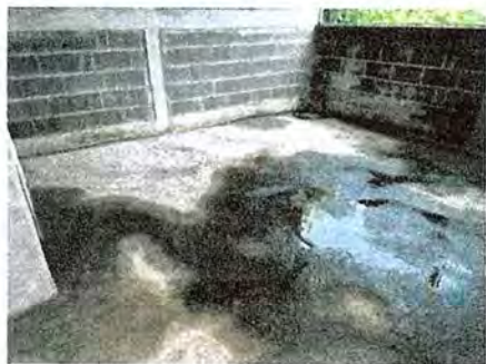
Foto 7: Se observa que no cuenta con piso cerámico.
