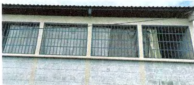
Foto 15: Se observa falta de ventanería en aulas que permiten el ingreso de agua
