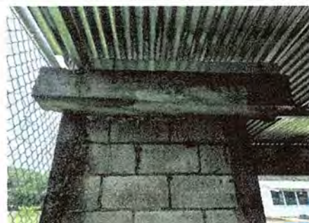
Foto 6: Se observa que el canal interior no tiene caída
