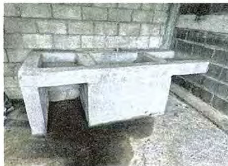
Foto 2: Se observa que las paredes no tienen aplicado cernido
