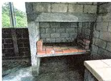
Foto 4: Se observa que la estufa no está funcional, no cuenta con ningún tipo de plancha ni el cubrimiento de ladrillo y la chimenea tiene filtración de agua cuando llueve.
