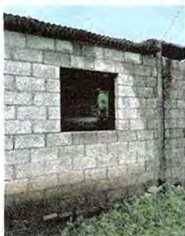
Foto 3: Se observa que las ventanas no tienen vidrio ni balcón de metal.
