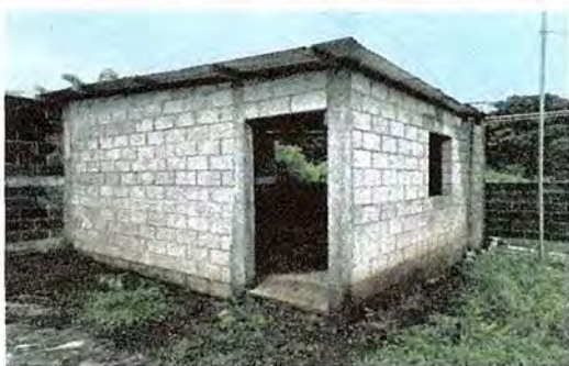
Foto 9: Se observa que el acceso a cocina no tiene puerta
