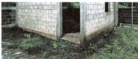
Foto 8: Se observa que el modulo no cuenta con banquetta de concreto
