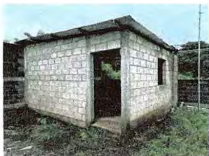
Foto 1: Se observa que la pared está de puro block y no tiene repello
