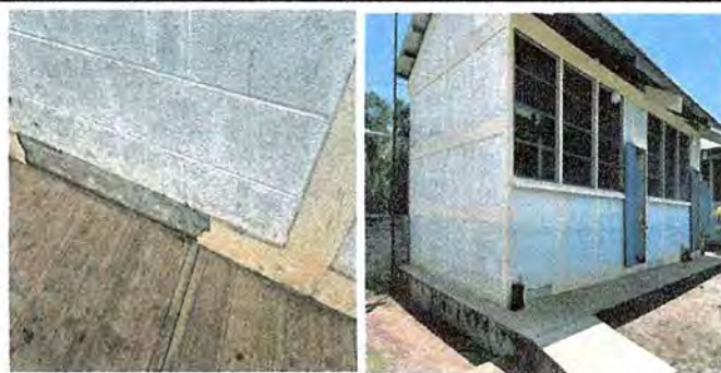
Foto 12: Se observa repello dañado en paredes de aulas
