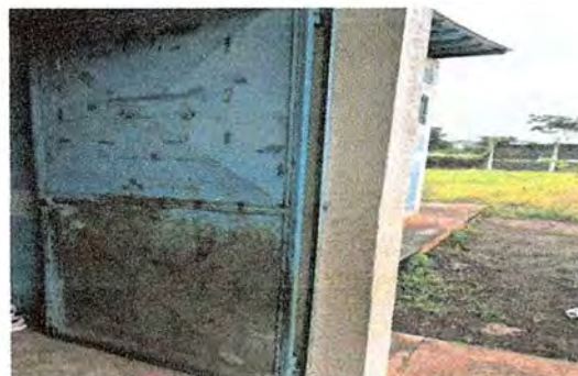
Foto 16: Se observa puerta con oxidación avanzada y falta de mantenimiento
