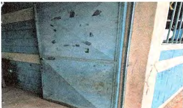
Foto 13: Se observan puertas de aulas con oxidación y falta de mantenimiento
