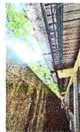
Foto 8: Se observa que el canal de agua de lluvia del módulo 1 ya se encuentra con agujeros y las bajadas no funcionan.
