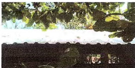
Foto 9: Se observa que la lámina del módulo 1 necesita aplicación de pintura anticorrosiva para poder preservarse por más tiempo.
