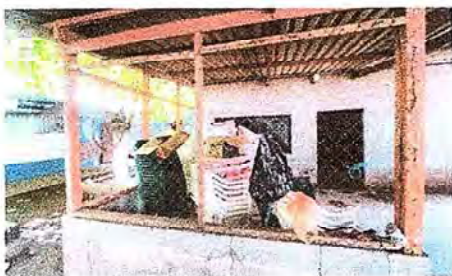
Foto 3: Se observa que la cocina cuenta con balcón de malla y es muy insegura, por lo que se necesita cambiarlos por balcones de metal.
