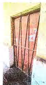
Foto 10: Se observa que las puertas en la bodega se encuentran en mal estado, es necesario sustituirlas.
