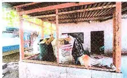
Foto 2: Se observa que es necesario elevar dos hiladas más de block al frente de la cocina.
