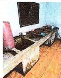
Foto 4: Se observa que las pilas fijas de la cocina ya presentan filtraciones y se requiere colocarles azulejo, tanto por dentro como en la parte del exterior.
