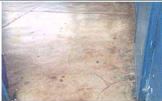
Foto 9: Se observa piso dañado.
