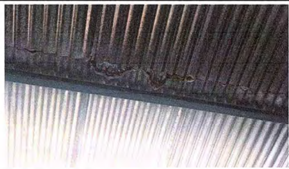
Foto 10: Se observa láminas en mal estado.
