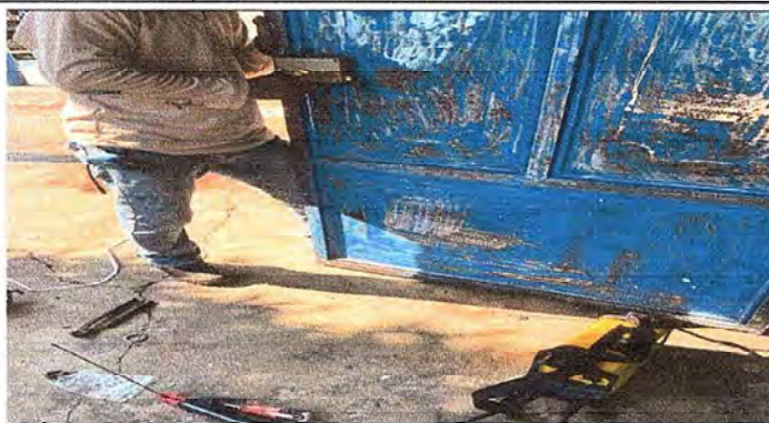
Foto 2: Se observa el proceso de las puertas de las aulas que necesitan mantenimiento.
