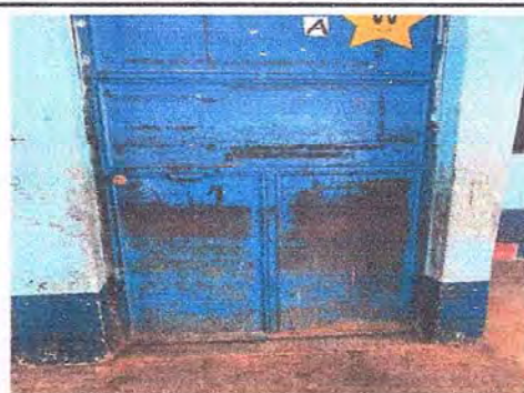
Foto 2: Se observa que las puertas de las aulas necesitan mantenimiento.
