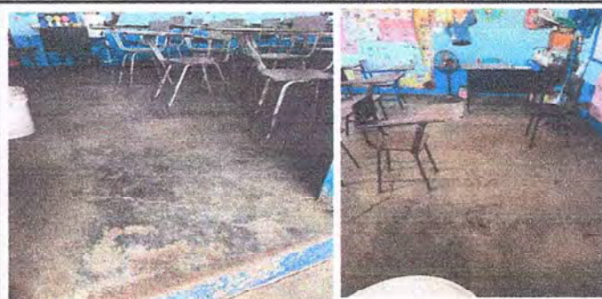
Foto 4: Se observa que el piso de las aulas se encuentra en mal estado.
