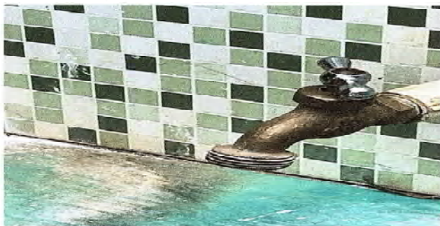
Foto 3: SE OBSERVA QUE EL CHORRO SE ENCUENTRA EN MAL ESTADO.
