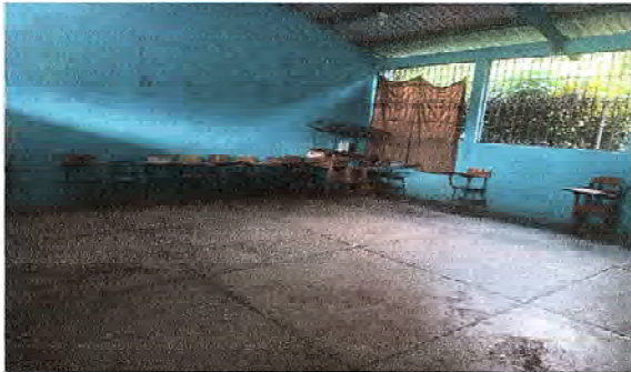
Foto 1: SE OBSERVA QUE EL PISO DE CEMENTO ESTA EN MAL ESTADO.
