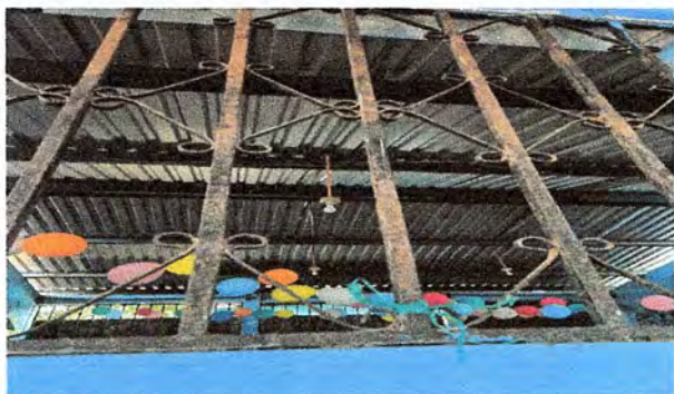
Foto 7: Se observa falta de mantenimiento y corrosión en blacones de metal en aulas.
