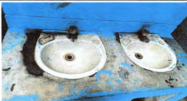
Foto 9: Se observa lavamanos deteriorados y en mal estado urge sustituirlos.
