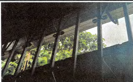
Foto 5: Se observa canal sin caída y daño en soporte.
