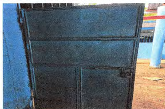
Foto 2: Se observa puertas en mal estado y avanzada corrosión y lámina dañada.
