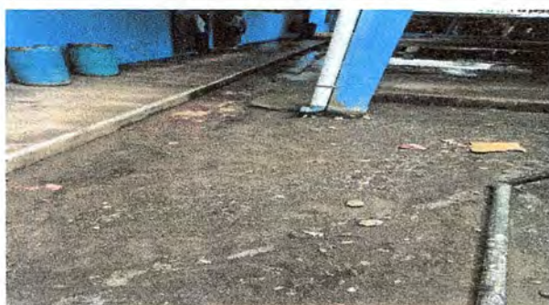
Foto 11: Se observa que urge reparación de torta de concreto en patio.
