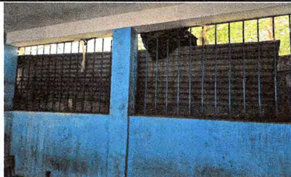
Foto 8: Se observa que urge un resane y aplicación de pintura en aulas, muros exteriores e interiores.
