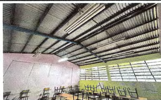
Foto 6: Se observa falta de iluminación y deficiencia.
