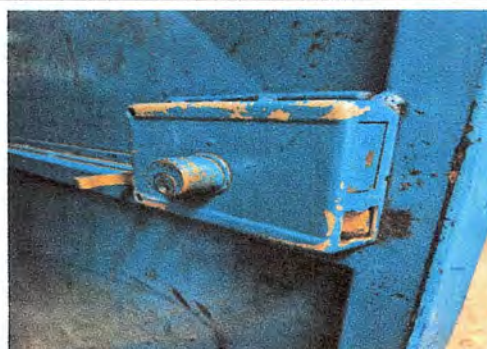
Foto 4: Se observa chapa en mal estado, se traba y no cierra.
