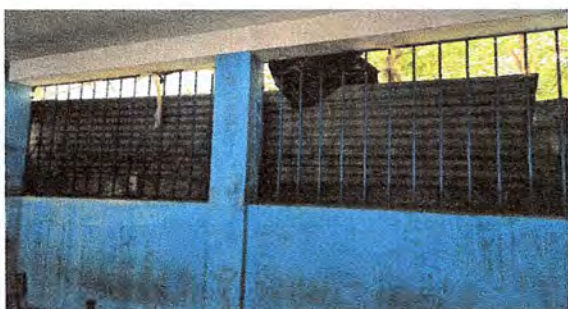
Foto 3: Se observa la falta de ventanas de vidrio para detener el ingreso de agua.
