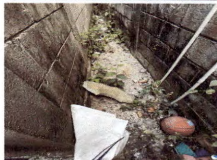
Foto 8: PARTE LATERAL DEL MÓDULO DE AULAS, CON PROBLEMAS DE ACUMULACIÓN DE AGUA
