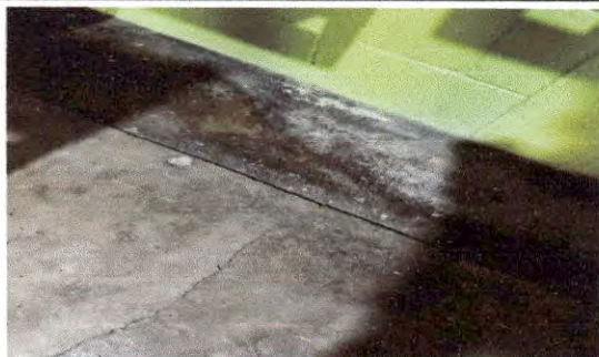
Foto 9: EL MURO EN LA PARTE BAJA COMIENZA A INDICAR PROBLEMAS DE HUMEDAD.
