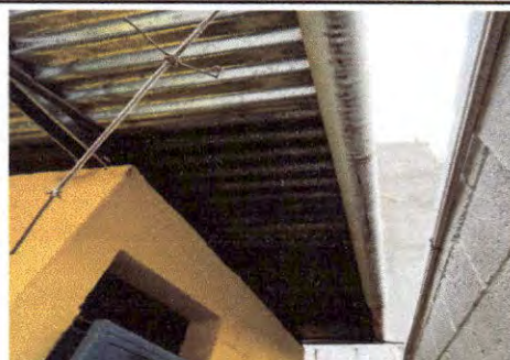
Foto 2: SECTORES DE TECHO DONDE LA APLICACIÓN DE LAMINA FUE VARIADA Y MAL COLOCADA
