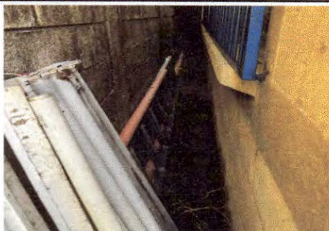
Foto 7: PARTE POSTERIOR DEL MÓDULO DE AULAS DE TIERRA, SIENDO UN PROBLEMA PARA LA TRANSMISIÓN DE HUMEDAD A MURO
