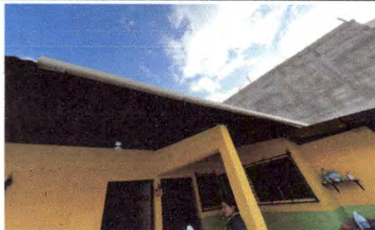
Foto 3: BAJADAS DE AGUA IMPROVISADAS PARA EVITAR ESCORRENTÍAS DE AGUA EN CORREDOR PRINCIPAL,
