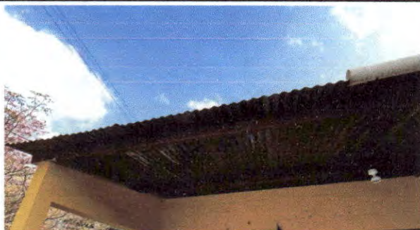
Foto 1: TECHO ONDULADO PANDEADO Y CON FILTRACIONES DE AGUA EN TRASLAPES.
