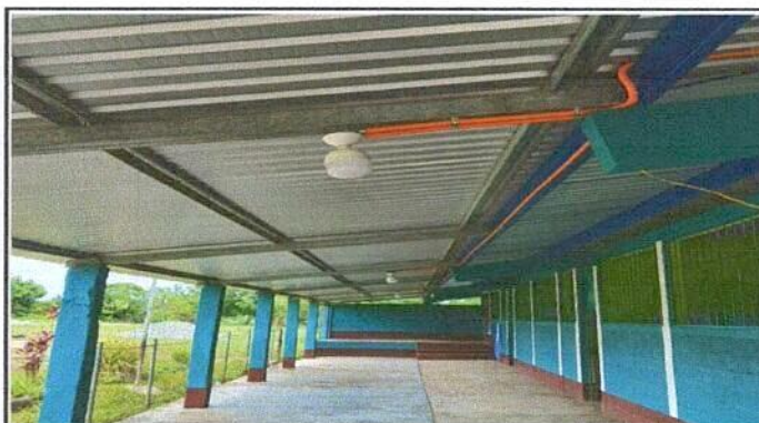
Foto 4: sistemaa electrico finalizada y entregada ya en uso.
