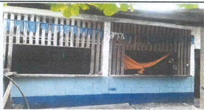
Foto 5: ventanas a sustituir
