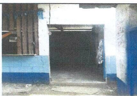
Foto 4: puerta a sustituir
