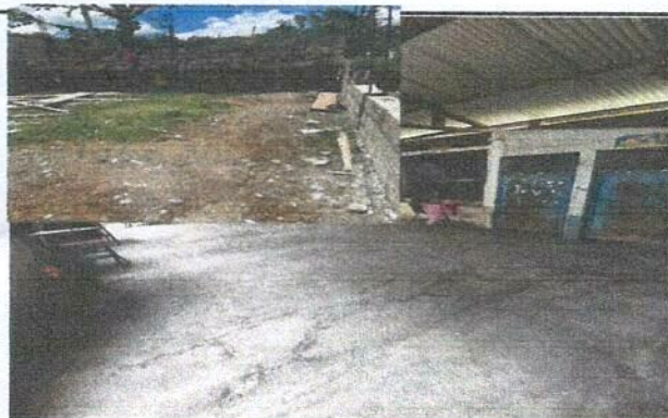
Foto 3: torta de cemento a sustituir
