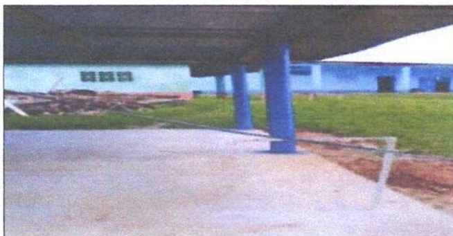
Foto 6: piso en muy mal estado con grietas.
