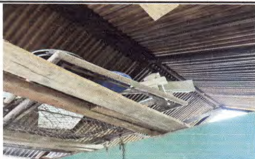
Foto 9: LÁMINA DE AULA CON PROBLEMAS DE FILTRACIONES DE AGUA Y PERFORACIONES.
