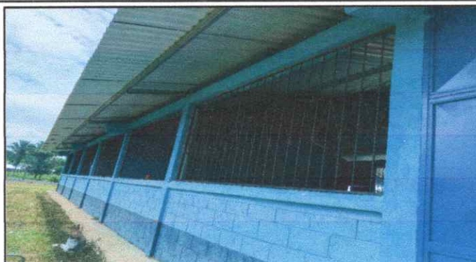
FOTO 1: Sustruicio de Balcones
