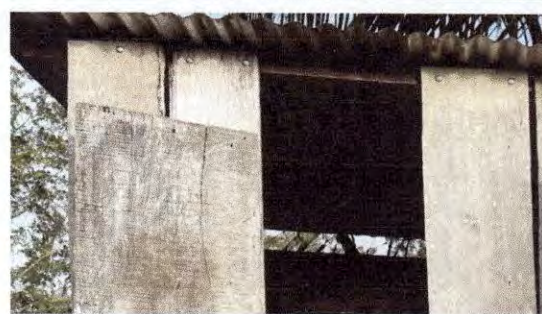
Foto 10: SANITARIO SIN PUERTA DE ACCESO, SIENDO ESTA DE TABLAS DE MADERA.
