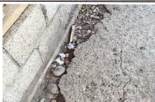
Foto 8: TORTA DE CONCRETO DE CORREDOR DE AULA, AL IGUAL QUE EL INTERIOR SIN REMATES EN MUROS CONCLUIDOS.
