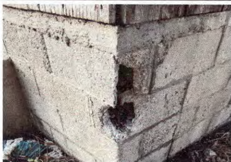
Foto 9: MUROS DE SANITARIOS INCOMPLETOS Y DAÑADOS.
