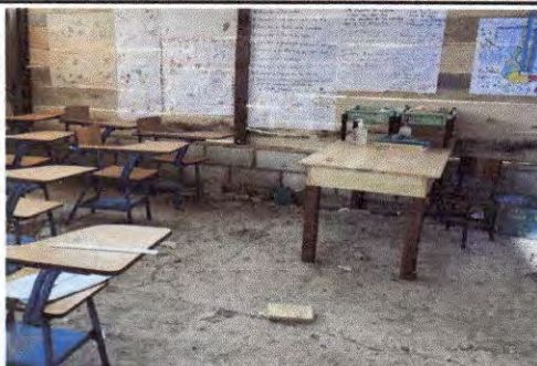
Foto 7: AULA CON PROBLEMAS DE MURO LATERAL INCOMPLETO.
